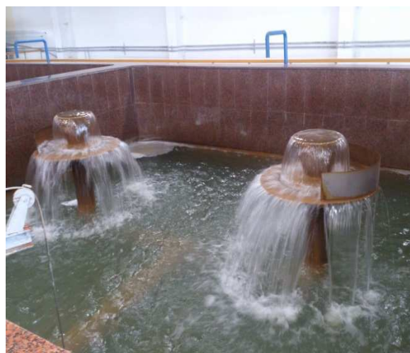
Рисунок 12 – Излив воды в корпусе фильтра
