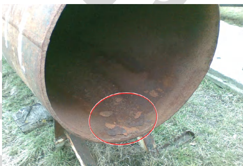
Рис. 1. Коррозионные повреждения внутренней поверхности газопровода
