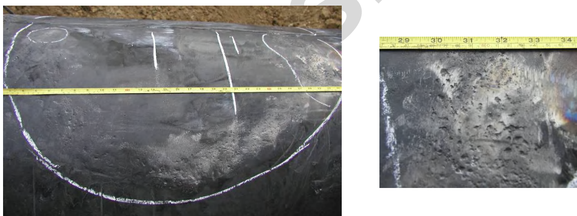
Рис. 2. Повреждение нефтепровода на переходе через железную дорогу
