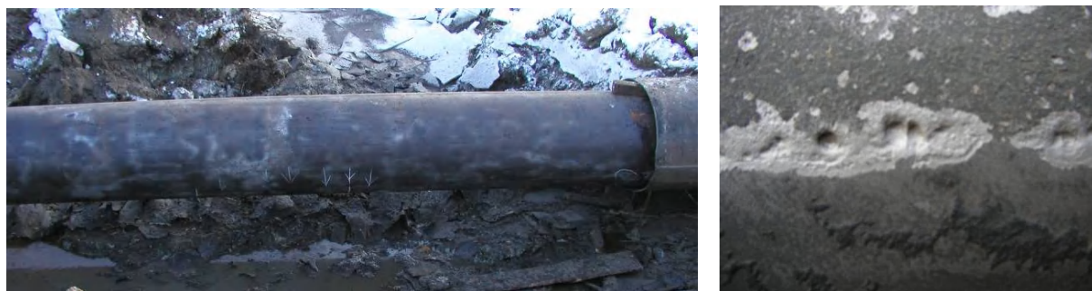
Рис. 3. Повреждение нефтепровода на переходе через малую водную преграду
