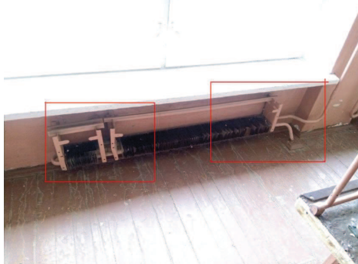
Рисунок 38 – Конвектор помещения №114 (мастерская по металлу), северный фасад
