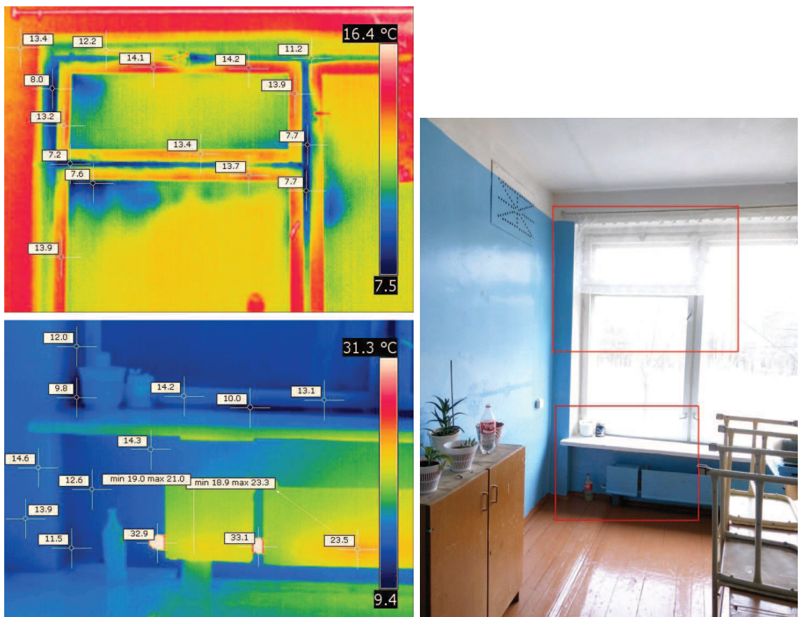
Рисунок 31 – Стена помещения №115 (мастерская по дереву), северный фасад
