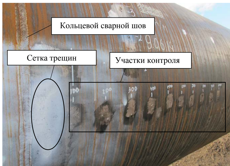
Рис. Дефектная труба с участками контроля
