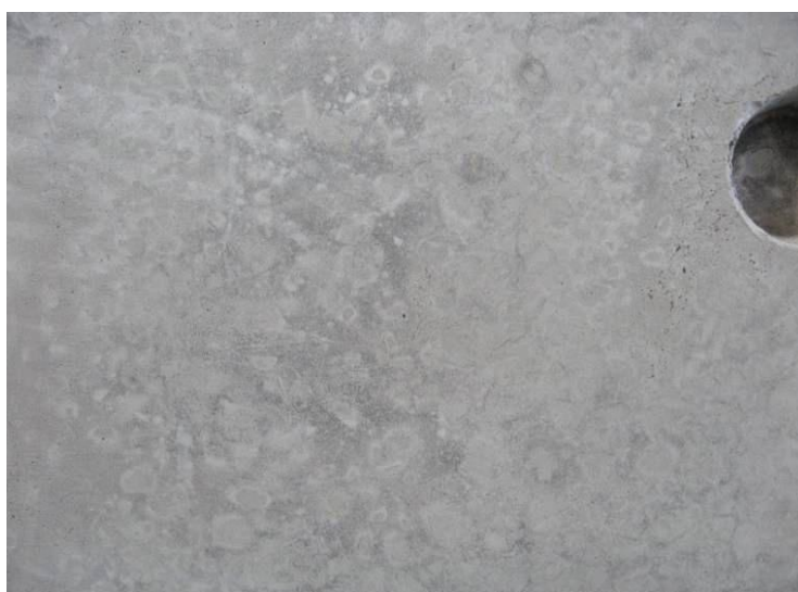
Рис. 6. Образец поверхности бетонной плиты после применения в качестве смазки для разборной стальной опалубки эмульсии на основе экстракта нефтяного, жирной кислоты растительных масел и неонола (концентрат эмульсола)
