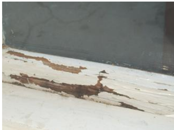
Рис. 4.7.3. Отслаивание краски ОК-2
