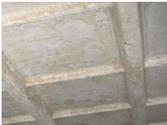
Рис.4.2.4. Оголение арматуры сетки полки плит покрытия П39-П41
