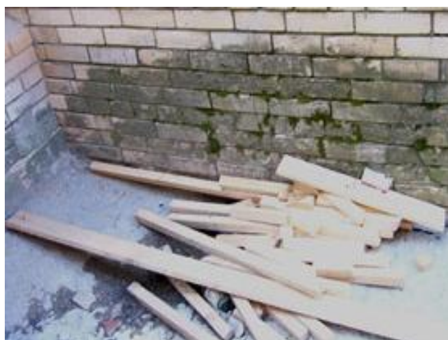
Рис. 4.9.1. Поражение участка цоколя грибком
