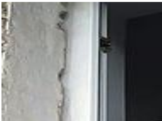
Рис. 4.7.2. Трещина в месте сопряжения коробки ОК-1 со стеной
