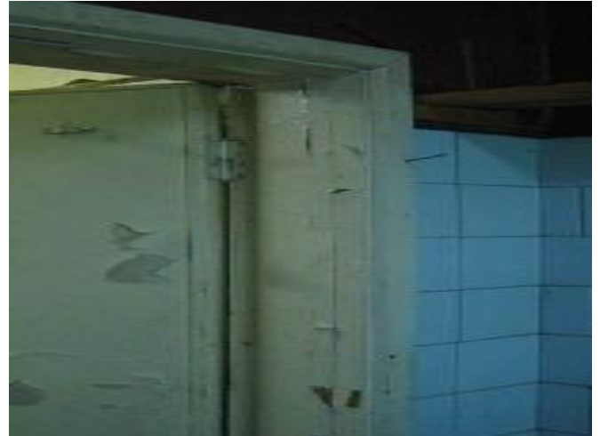
Рис. 4.6.3. Шелушение краски дверного полотна, откосов и наличников Д-13
