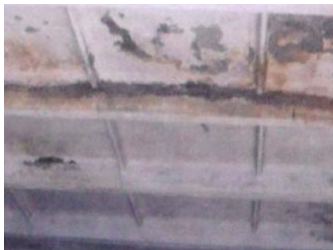
Рис.4.2.3. Следы отслоения защитно-отделочного слоя на плите покрытия П44
