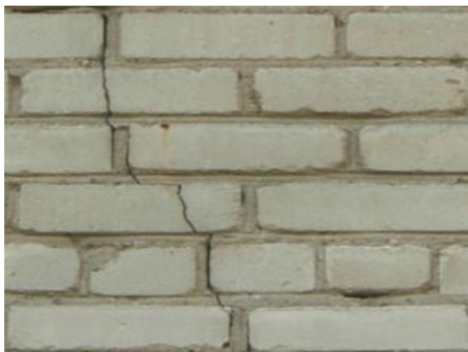
Рис. 4.5.4. Трещина, шириной раскрытия 1-2 мм на фасаде С1
