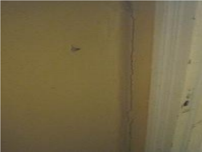
Рис. 4.6.2. Вертикальная трещина по стыку дверной коробки с поперечной стеной Д-12
