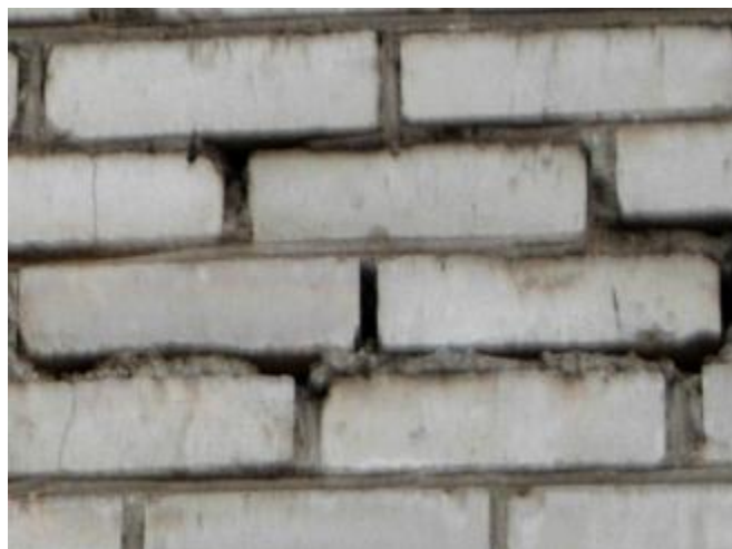
Рис. 4.5.3. Незаполненные раствором швы на фасаде С2
