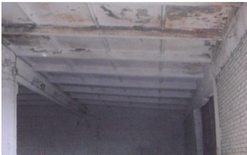
Рис. 4.1.1. Следы увлажнения плит покрытия
