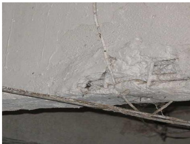
Рис.4.3.2. Продольные трещины в нижней грани стенки балки Б8, отслоение защитного слоя рабочей арматуры
