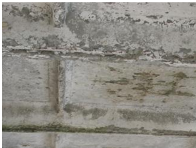
Рис.4.2.5. Трещины в продольном ребре, отделение защитного слоя бетона, оголение и коррозия рабочей арматуры плит покрытия П58-П60
