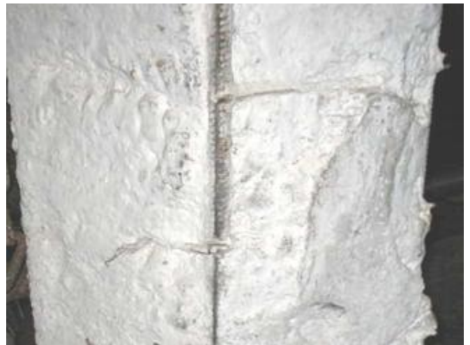
Рис. 4.4.3. Состояние колонны К8
