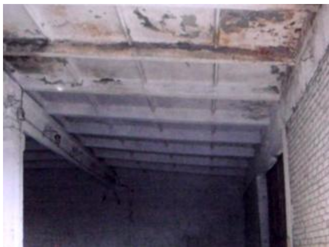
Рис.4.2.2. Следы намокания на плитах покрытия П29, П30, П31
