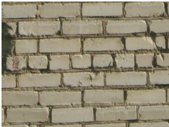
Рис. 4.5.2. Наличие выбоины на фасаде С1
