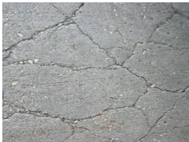
Рис. 4.8.3. Волосяные трещины, мелкие выбоины 7-1
