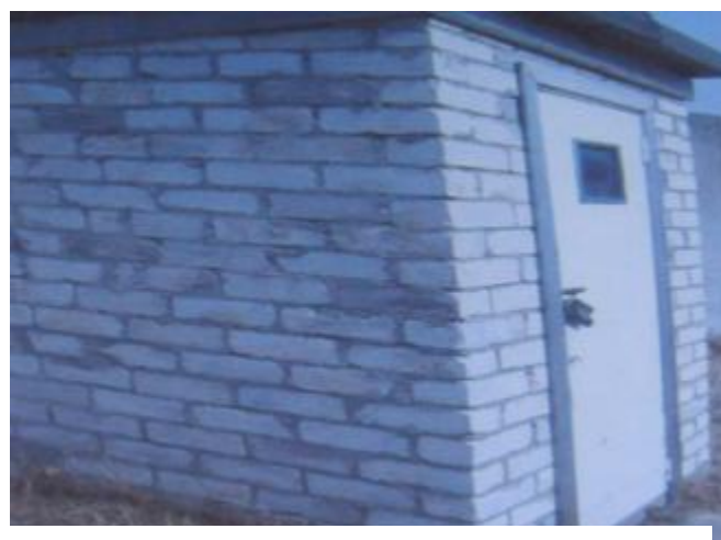
Рис. 4.5.5. Наличие выбоин кирпича на наружной стене тамбура
