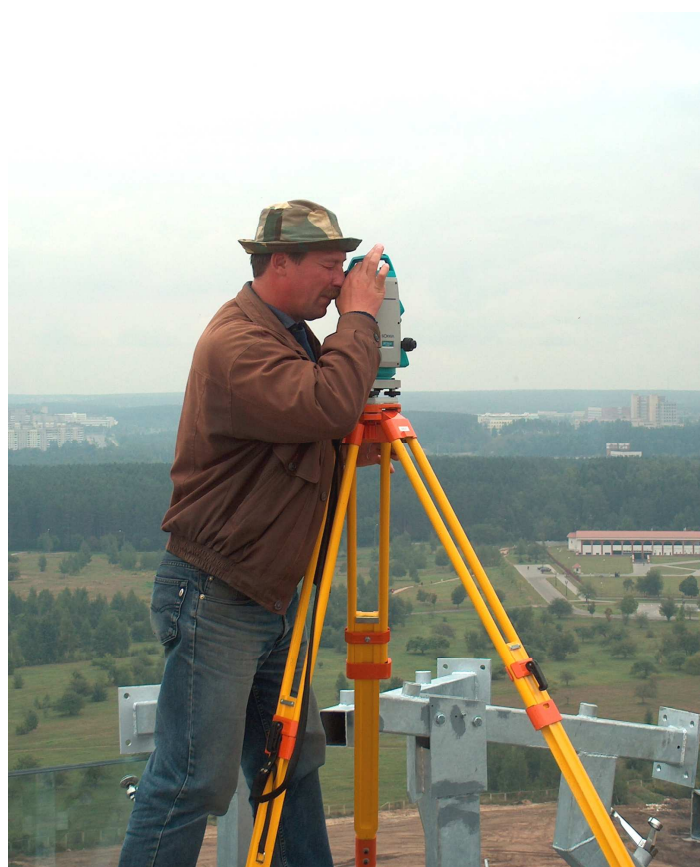
Рис. 1.3. Вынос разбивочных осей на монтажный горизонт при строительстве национальной библиотеки с помощью электронного тахеометра доц. В.В. Ялтыховым
