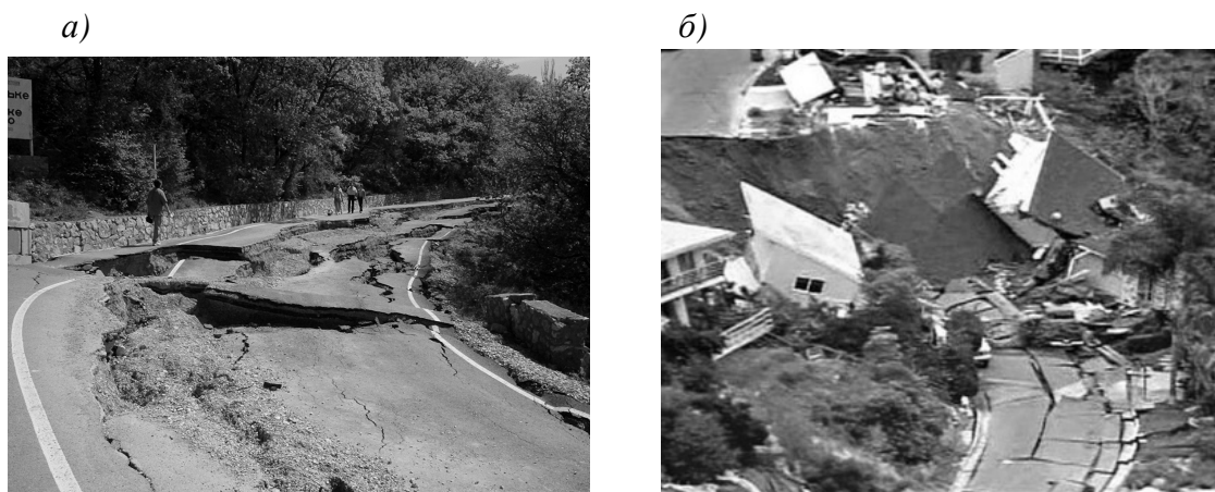
Рис. 10.2. Оползень дороги в Крыму (а); разрушение домов в результате образования оползня (б)
