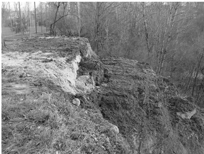
Рис. 10.7. Обрушение склона Гапеева ручья вблизи стадиона медуниверситета в г. Витебске
