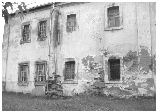
Рисунок 10 – Размораживание штукатурного слоя и кирпичной кладки на западном фасаде секции № 2
