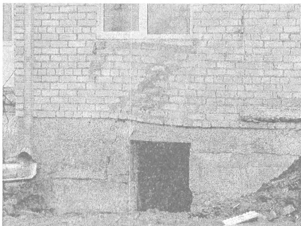
Рис. 2. Повреждение несущих стен здания.
