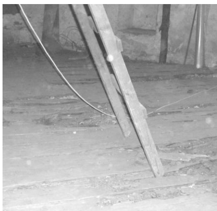
Рис. 5. Гниlostные повреждения деревянного пола
