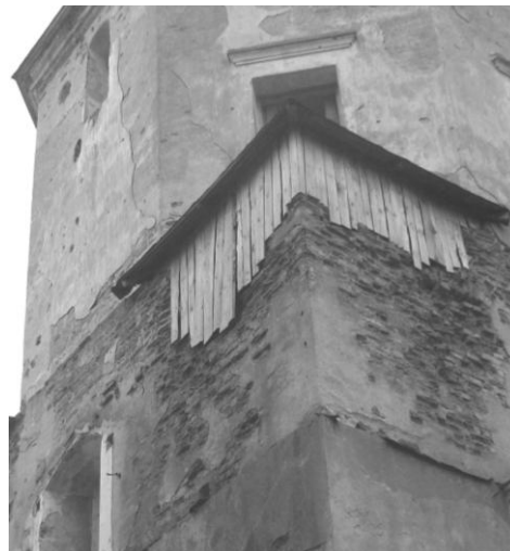
Рис. 2. Разрушение верхних рядов кирпичной кладки стены 2-го этажа
