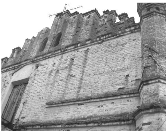
Рис. 16. Разрушение верхних рядов кладки декоративной башни и южного фронтона
