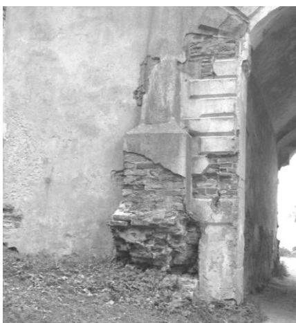
Рис. 3. Разрушение декоративной кладки
