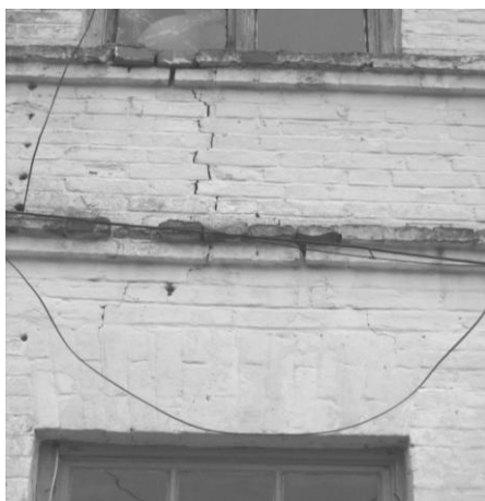
Рис. 18. Сквозная трещина по наружной стене между оконными проемами 1-го и 2-го этажа
