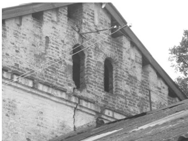
Рис. 17. Сквозная трещина по торцевой стене и северному фронтому
