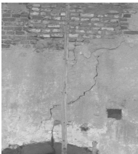
Рис. 10. Сквозная трещина на северной стене между проемами 2 и 3-го этажа
