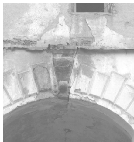
Рис. 4. Сквозная трещина в башне по своду и стене. Фрагмент сграффито над въездом в башню
