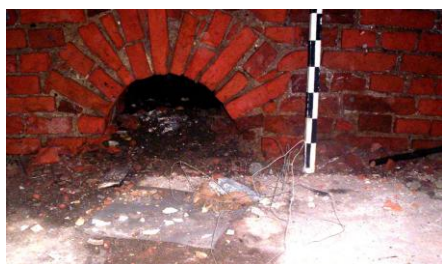
Мал. 5. Акенца для выпуску дрэнажнай трубы ў вонкавай паўночнай сцяне корпуса «А» пад калідорам
