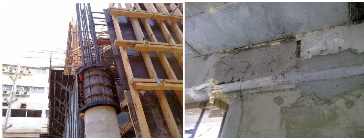
Рисунок 8. – Недостаточная длина арматуры. Плохая очистка и подготовка бетонных поверхностей в области рабочего шва
