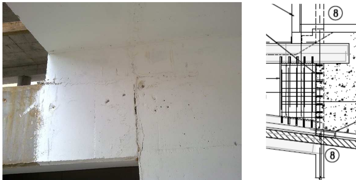
Рисунок 9. – Трещины в области опирания балки рампы на железобетонную стену и деталь усиления
