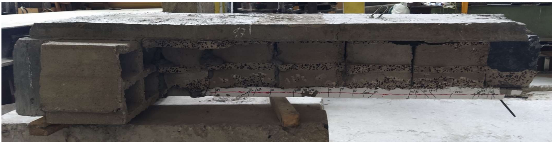
Рисунок 2.8 – Левая часть балки после разрушения (сторона А)
