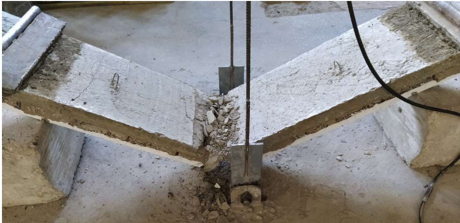
Рисунок 2.13 – Разрушенный фрагмент перекрытия
