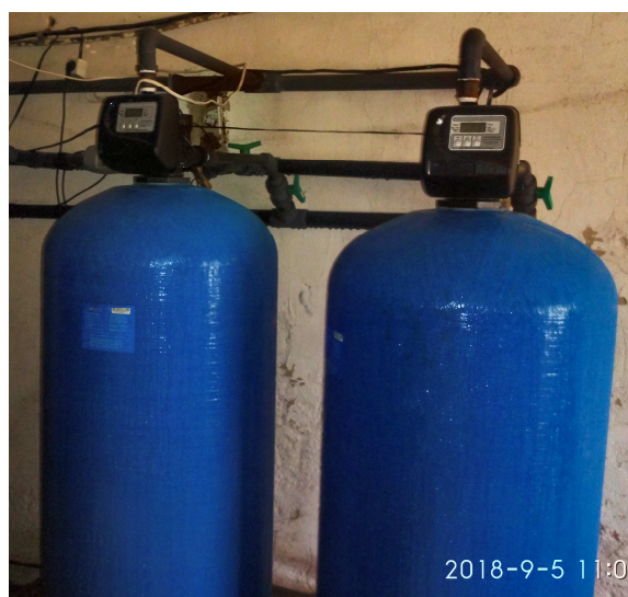
Рисунок 1. – Общий вид установки водоподготовки
