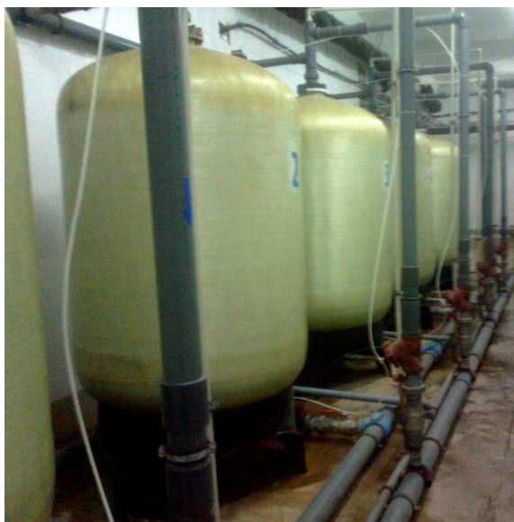
Рисунок 3. – Станция обезжелезивания воды на объекте №Б
