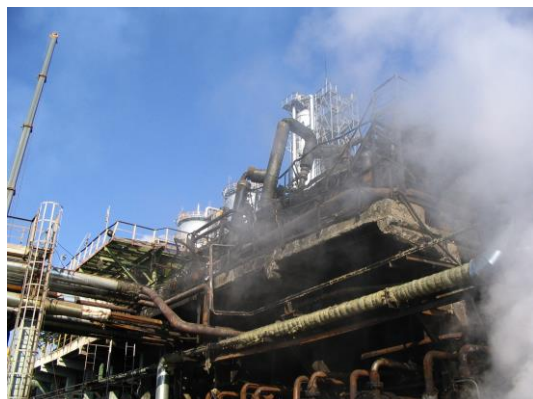
Рис. 2. Внешний вид поврежденного пожаром постамента теплообменников технологической установки АВТ-2 ОАО «Нафтан»
