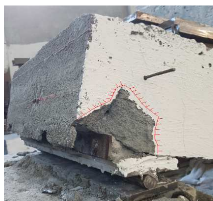
Рисунок 7. – Фото смятия бетона анкерочным уголком в приопорной зоне
