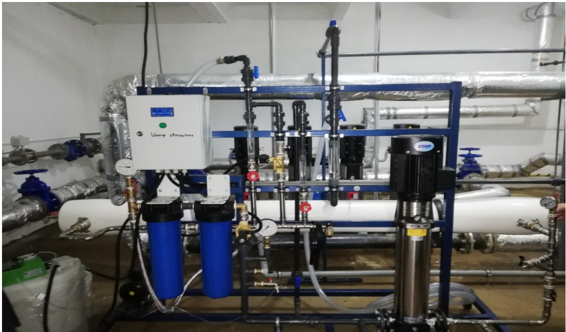
Установка обратного осмоса (3 м 3 /ч) для обессоливания воды (г.п. Воропаево, Докшицкий район, Витебская область).
