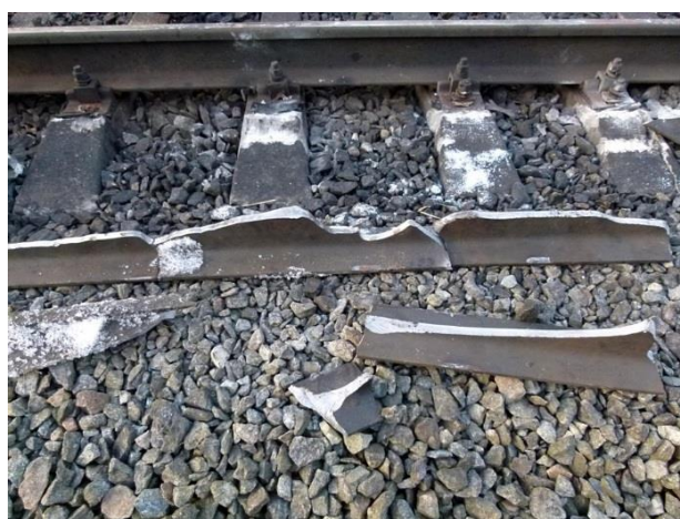
Рисунок 1.2 - Излом рельса по коду дефекта 21.2
