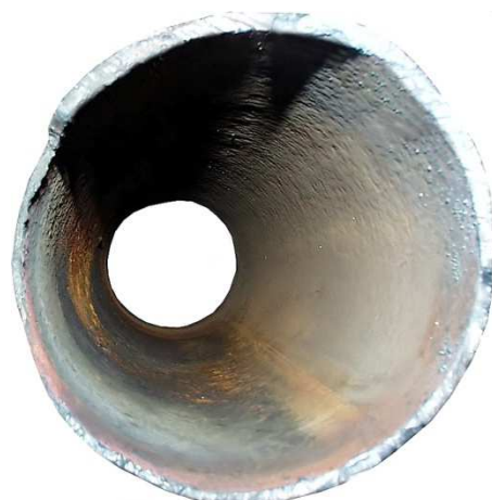
Рисунок 1. – Общая коррозия трубы змеевика печи (сталь 20)
