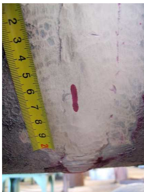
Рисунок 5. – Разрушение сварного соединения трубопровода вследствие тепловой хрупкости металла
