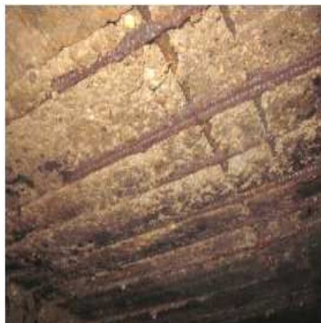
Рис. 2. Фрагмент железобетонной плиты перекрытия (отслаивание и разрушение защитного слоя)
