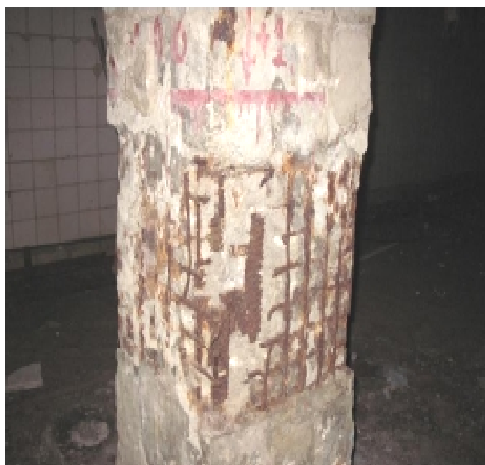
Рис. 1. Фрагмент коррозии железобетонной колонны
