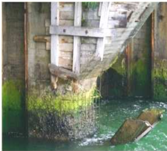
Рис. 3. Коррозия железобетона в зоне переменного уровня морской воды
