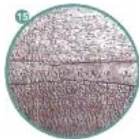
Рис. 8.4. Обнаруженное с помощью методов контроля коррозионное растрескивание в присутствии механических напряжений (внутренняя поверхность трубы)
