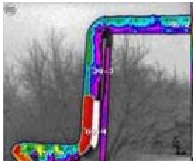
Рис. ПА.3. Нарушенная теплоизоляция надземного трубопровода
