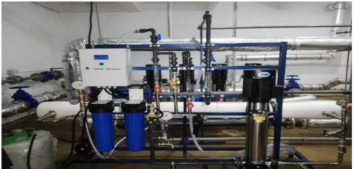
Рисунок 4.1 - Установка обратного осмоса г. Воропаево для обессоливания воды. Докшицкий район, Витебская область.
