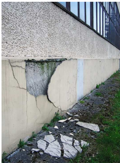
Рисунок 1.10. – Негативные последствия нарушения сцепления штукатурки и бетона
