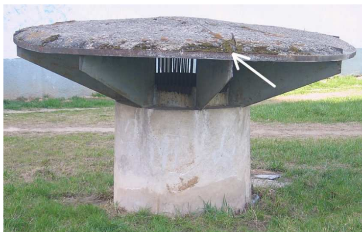
Рисунок 1.18. – Биокоррозия стального элемента вентиляционной шахты в местах его контакта с мхом; на одно из таких мест указывает стрелка
