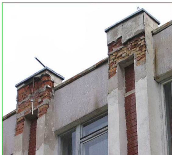
Рисунок 1.8. – Разрушение оштукатуренной кирпичной кладки в верхней части здания вследствие замерзания накопившейся в ней влаги
