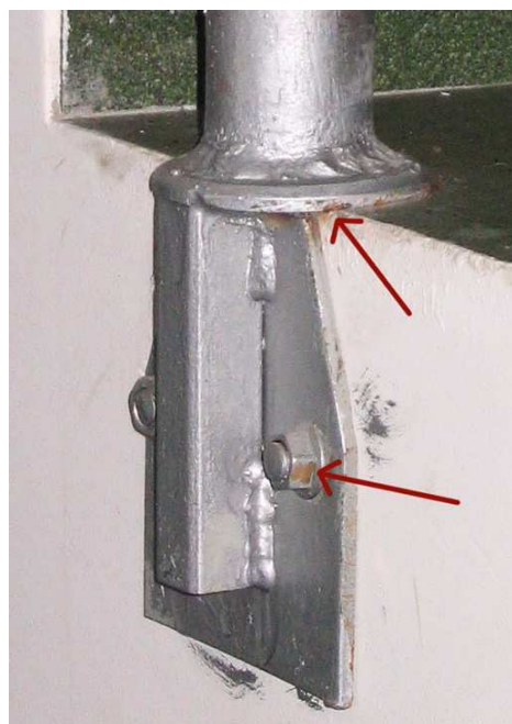
Рисунок 1.1. – Коррозия стальных элементов лестницы общественного здания вследствие их некачественной окраски; на два места с ржавчиной указывают стрелки
