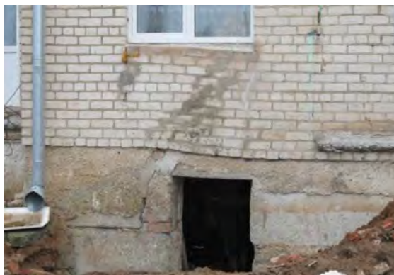
Рис. 2. Общий вид поврежденной стены (трещины заделаны раствором)
