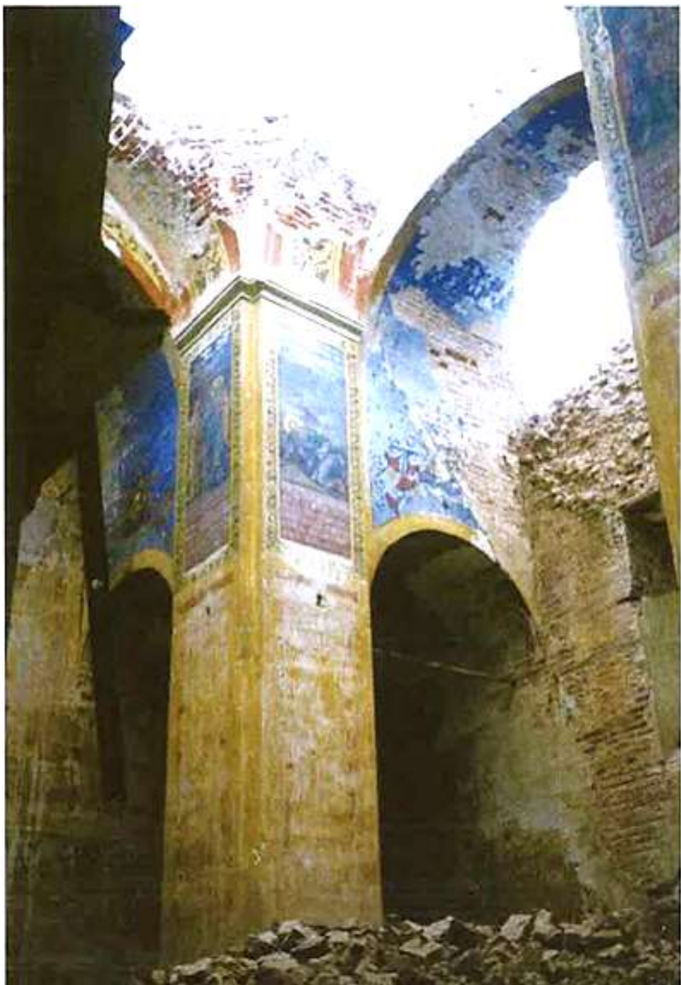
Рисунок 1. – Конструкции Рождественского собора после обрушения: юго-восточный пилон собора (Начало)
