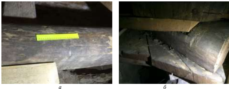
а – летные отверстия; б – осыпи буровой муки Рисунок 6. – Конструкции чердака
