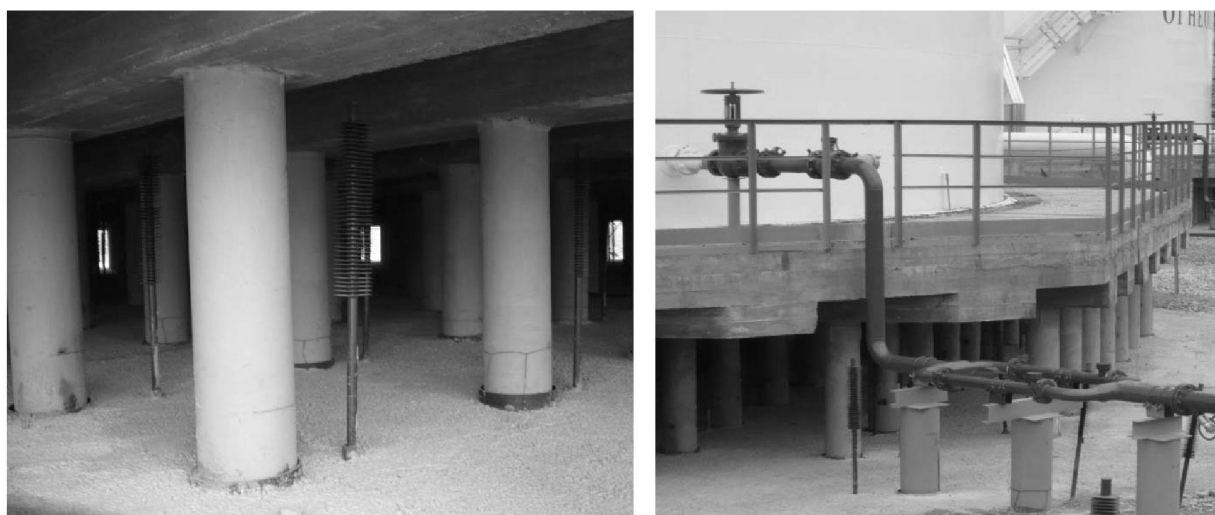
Рис. Применение сезонно-охлаждающих устройств на примере РВС-5000
