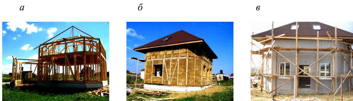
Рис. 67. Этапы строительства дома из соломенных блоков: а – устройство деревянного каркаса; б – устройство кровли и заполнение каркаса соломенными блоками; в – оштукатуривание фасада
