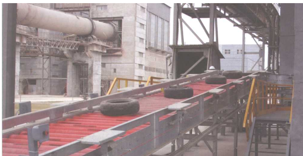
Рис. 55. Установка по утилизации изношенных автомобильных покрышек во вращающейся печи обжига клинкера в ОАО «Красносельскстройматериалы»
