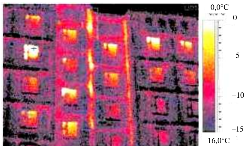
Рис. 65. Брак в выполнении плоского вертикального шва между стеновыми панелями
